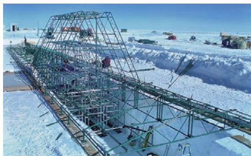
掘削施設 この屋根部分に CFRP が使われる
