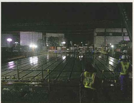
全ての橋桁がかけ終わったところ(3日目。前日から冷たい雨になった。)
